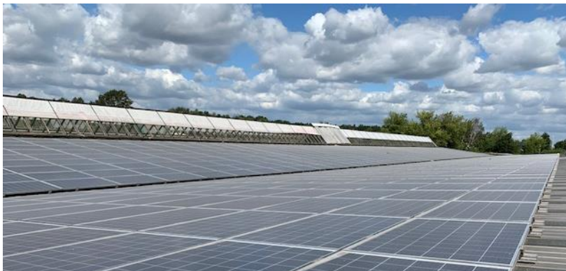
Die PV-Aufdachanlage befindet sich auf den Dächern eines Milchviehbetriebs.
